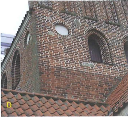
Billede D. Kirketårn skadet på grund af fugning med mørtel med for lille kalkindhold. Den lyse farve på stenene skyldes, at brændhuden er frosset af.
